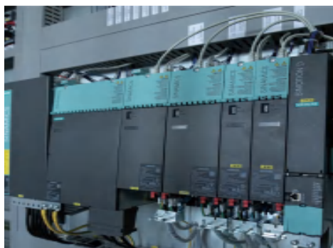
■ 变频柜 VFD Cabinet
